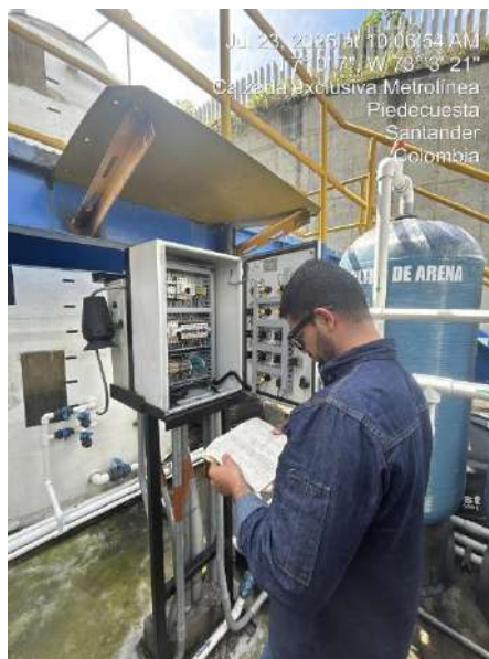
Mantenimiento preventivo PTAR
